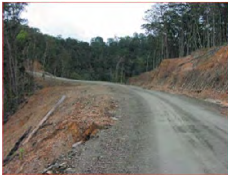
Gambar 37. Jalan Yang Di Balast Dan Dipadatkan Dengan Baik. Perhatikan Puing Kayu Yang Diletakan Di Pinggir Jalan Untuk Mengurangi Erosi.
