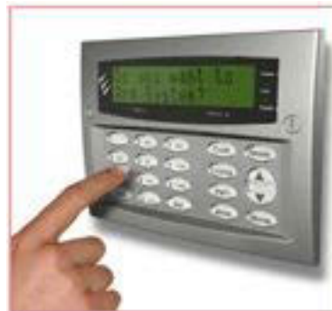
Gambar 4.15.: Kontrol Alarm dengan keypad
