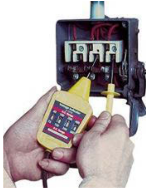
Gambar 8.10.: Test tegangan jaringan
