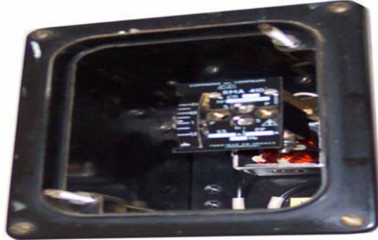
Gambar 3.34 : relai hubung tanah pada trafo
