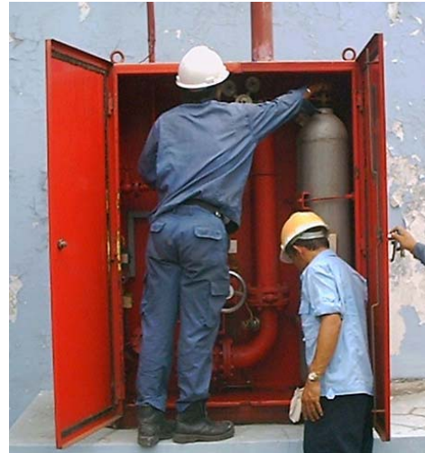
Gambar 3 24 alat pemadam kebakaran tranformator
