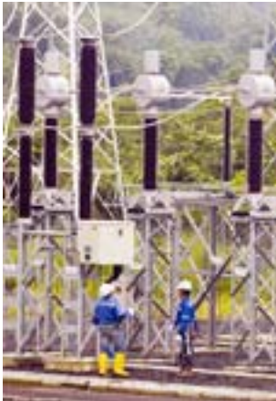
Gambar 8.1 Pembangkit tenaga listrik
